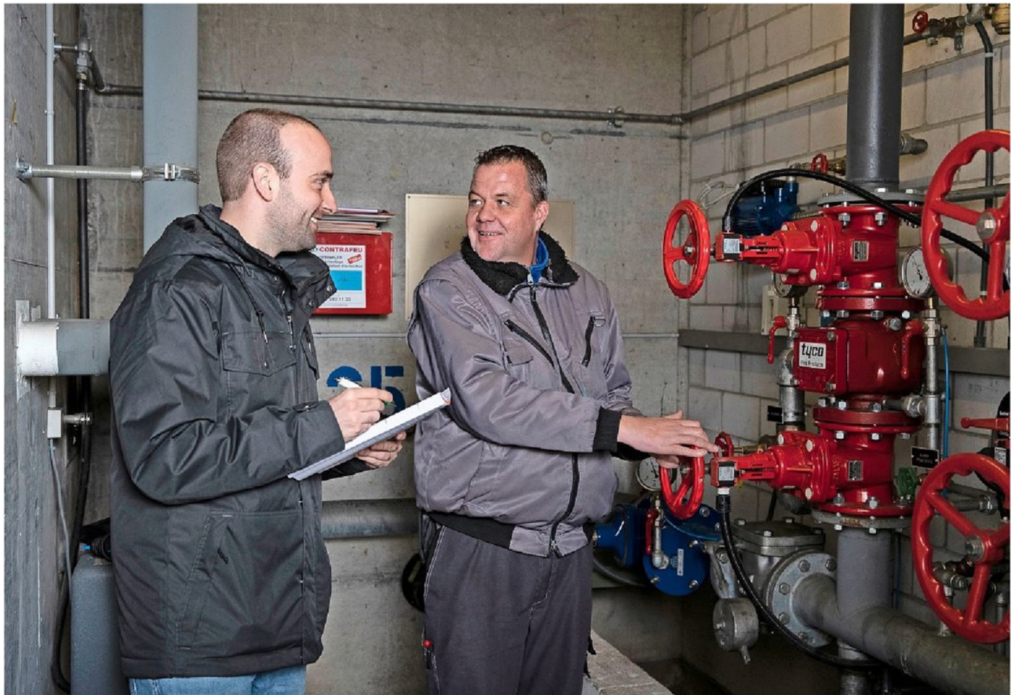
Thomas Graf (links) und Mario Ledermann bei der Kontrolle der Sprinkleranlage. Foto: Nicole Philipp
